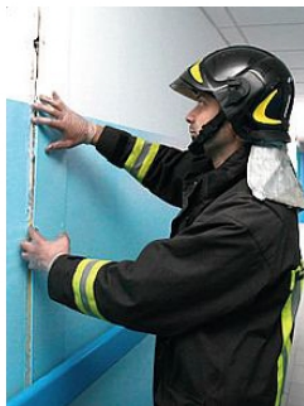
Controlli a una crepa dopo il sisma
