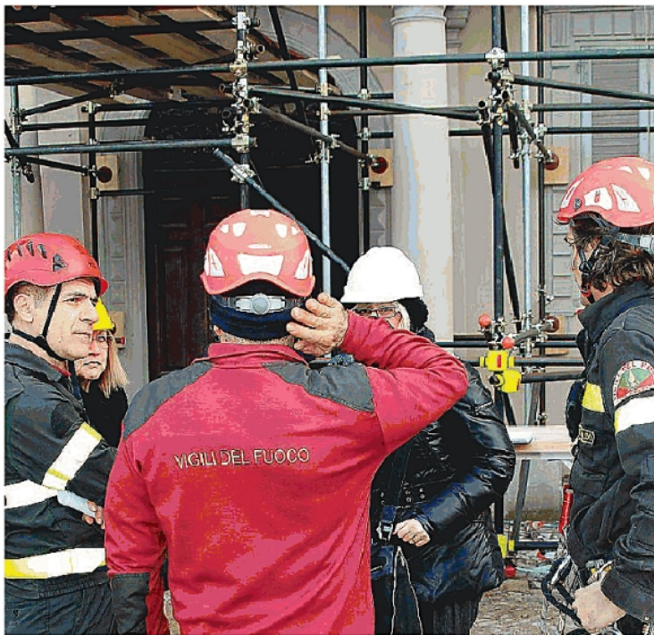
Vigili del fuoco impegnati nel mettere in sicurezza il municipio di Concordia e la chiesa di Rovereto
