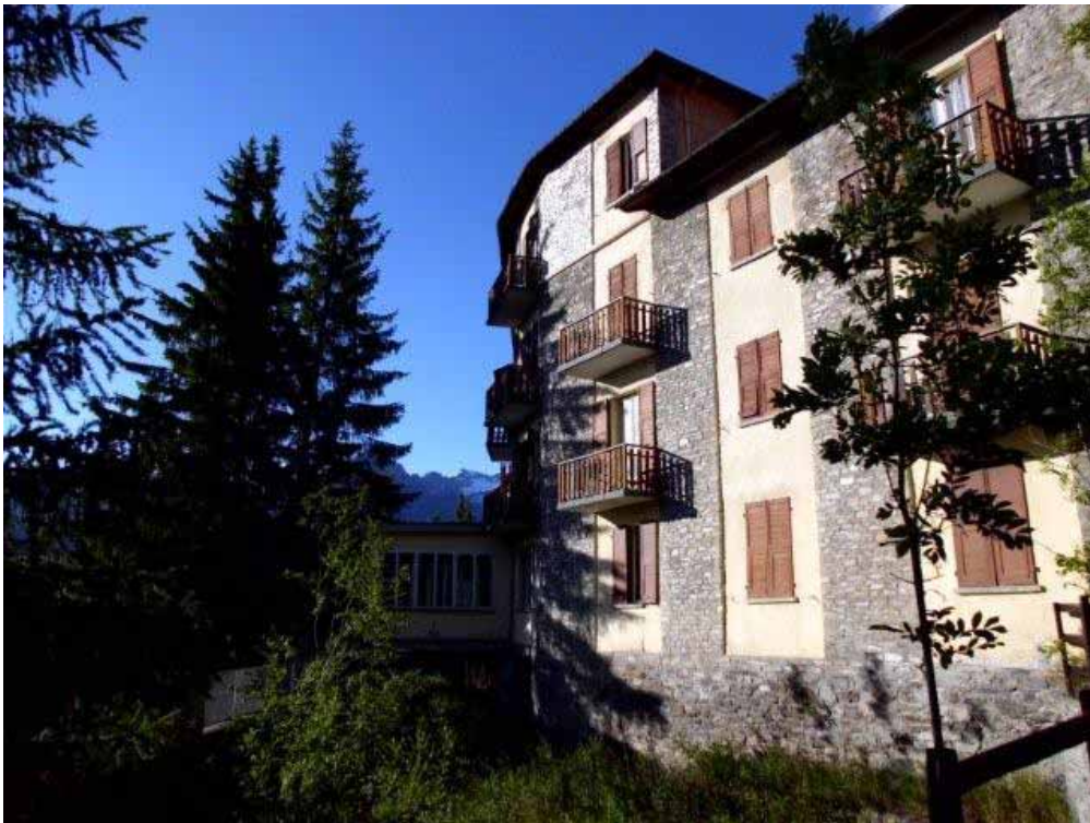
Figura 10: VISTA DEL CENTRO - SI NOTANO LE PERSIANE LASCIATE APERTE E ROTTE, OLTRE ALL'ERBA CHE ORMAI ARRIVA AL PRIMO PIANO DELL'EDIFICIO.
