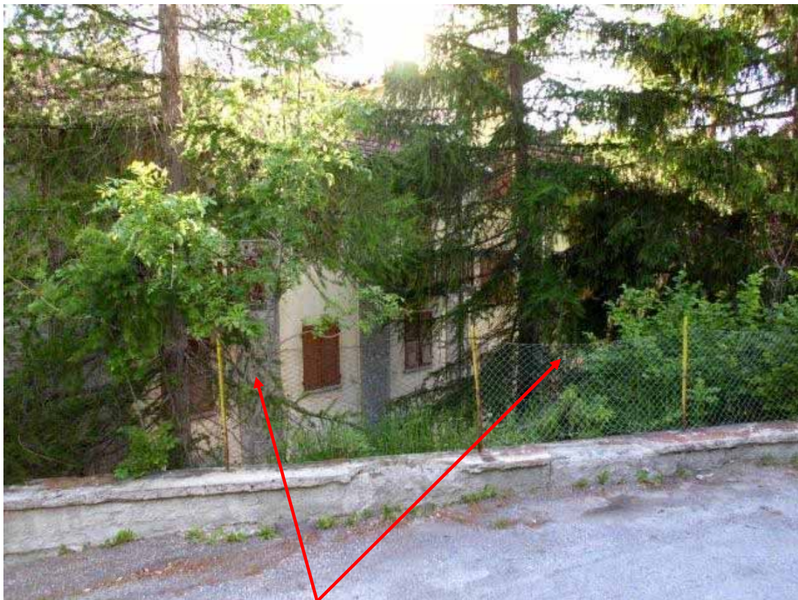
Figura 13: VISTA DAL LATO POSTERIORE DEL CENTRO ONA - SI PUO' NOTARE LA RETE DI RECINZIONE PIEGATA COME ACCADE QUANDO QUALCUNO "SCAVALCA" PER ENTRARE.
