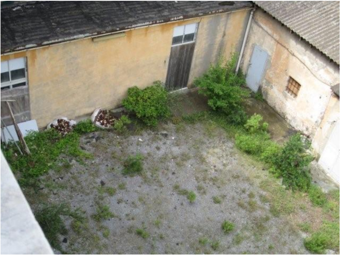
Figura 68: ALTRO PIAZZALE INTERNO IN STATO DI ABBANDONO
