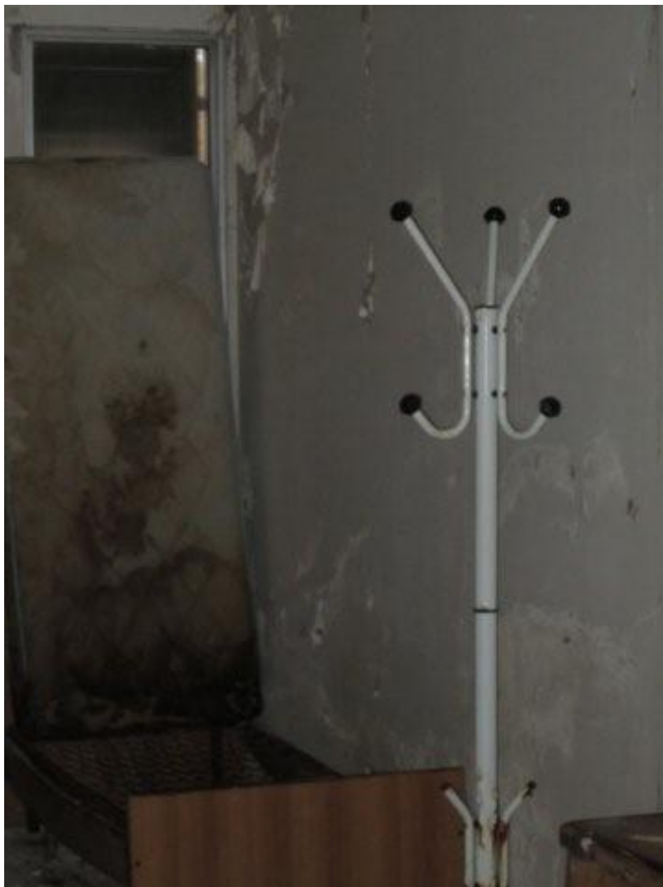
Figura 57: ALTRO MOBILIO IN STATO DI ABBANDONO.
