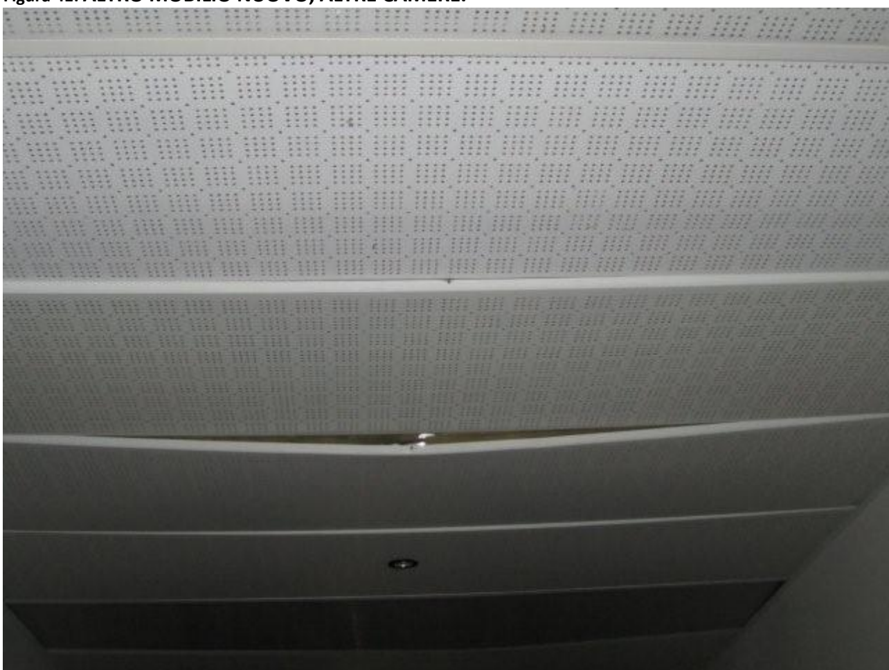
Figura 42: CONTROSOFFITTI NUOVI CHE INIZIANO A CADERE CAUSA INFILTRAZIONI DI ACQUA..
