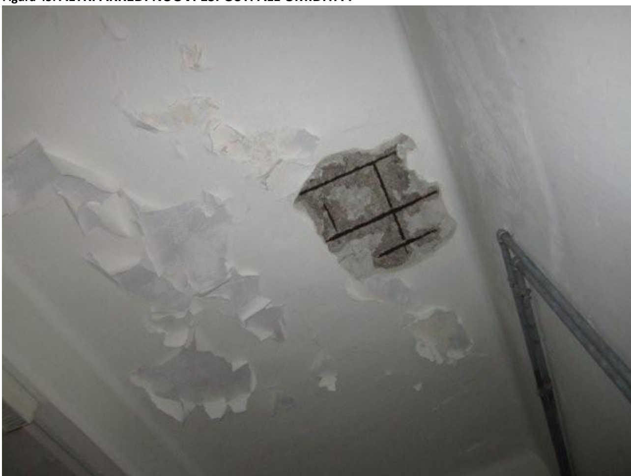
Figura 46: SOFFITTI IN DEGRADO CAUSA UMIDITA' DAL TETTO.
