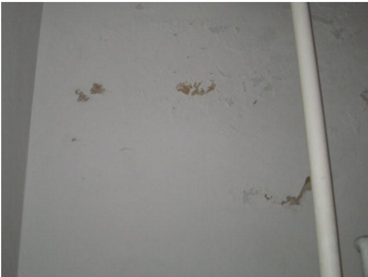
Figura 39: UMIDITA' NEI BAGNI NUOVI.
