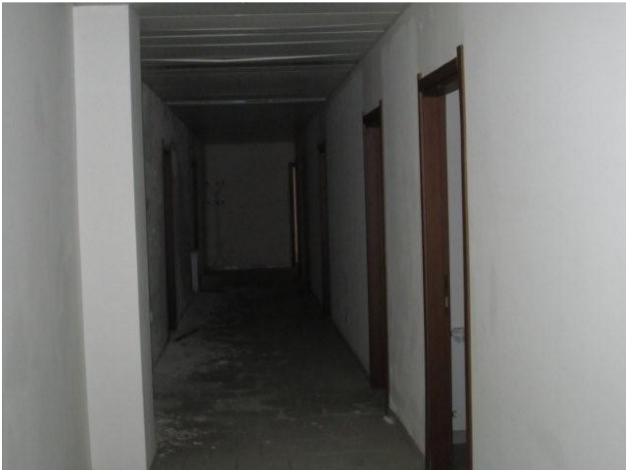
Figura 23: ALTRE PORTE INTERNE NUOVE CHE FANNO DA CONTORNO ALLO SFACELO IN ATTO.
