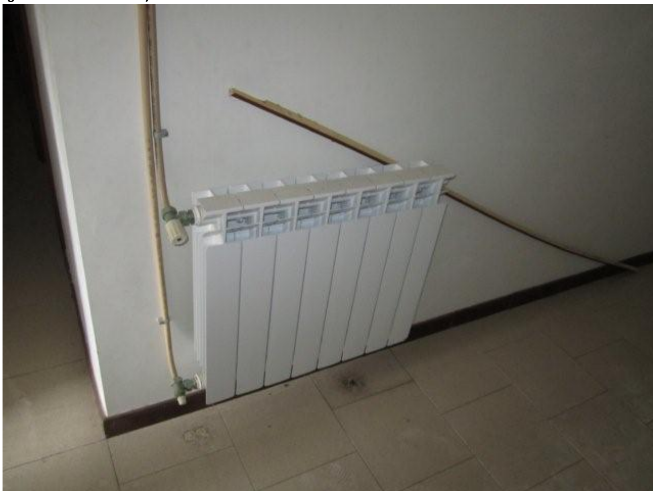
Figura 55: IMPIANTO DI RISCALDAMENTO RIMESSO A NUOVO IN TUTTO LO STABILE.
