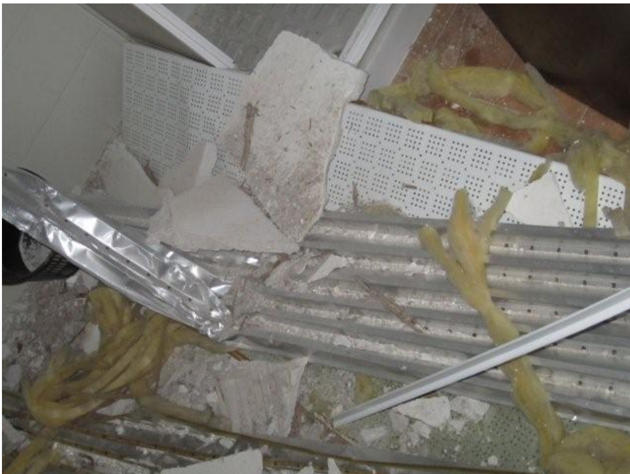
Figura 35: PARTI DI CONTROSOFFITTATURA NUOVA, CADUTA SEMPRE A CAUSA DI INFILTRAZIONI DI ACQUA.
