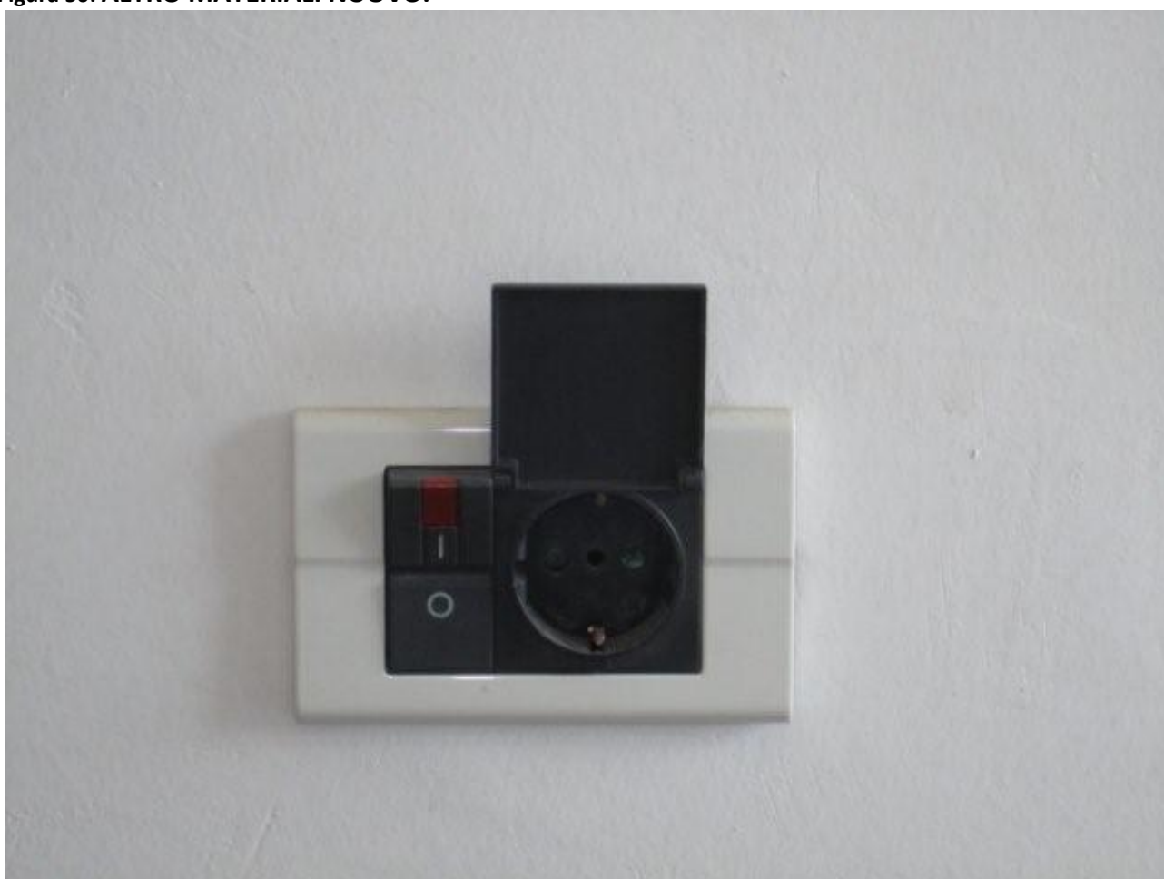
Figura 51: IMPIANTI ELETTRICI VEROSIMILMENTE GIA' MESSI A NORMA.
