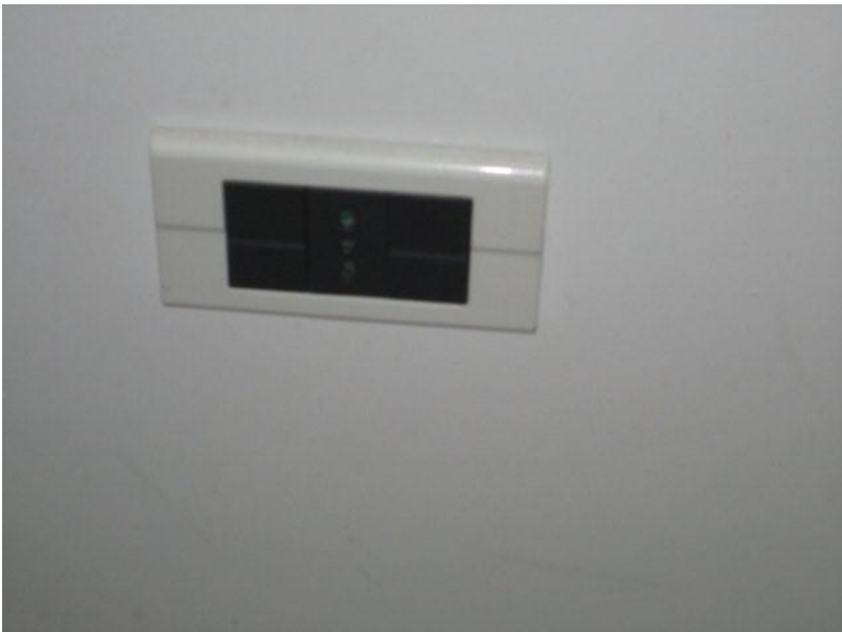
Figura 53: ALTRE PARTI DI IMPIANTO ELETTRICO CHE EVIDENZIANO LE SPESE EFFETTUATE PER LA MESSA A NORMA.
