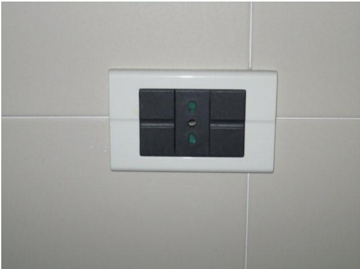
Figura 61: ALTRE PARTI DI IMPIANTO ELETTRICO, TENENDO CONTO CHE QUESTA STRUTTURA, E' COMPOSTA DA DECINE E DECINE DI CAMERE.
