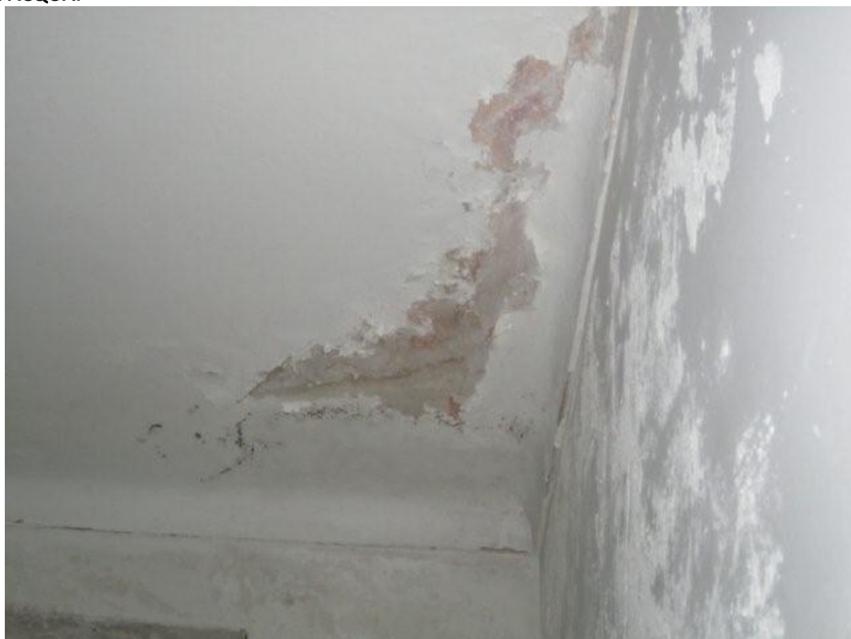
Figura 36: INFILTRAZIONI DI ACQUA.
