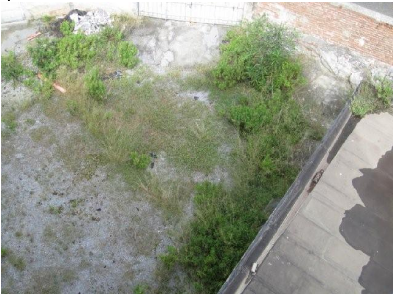
Figura 67: PIAZZALE INTERNO IN STATO DI ABBANDONO.
