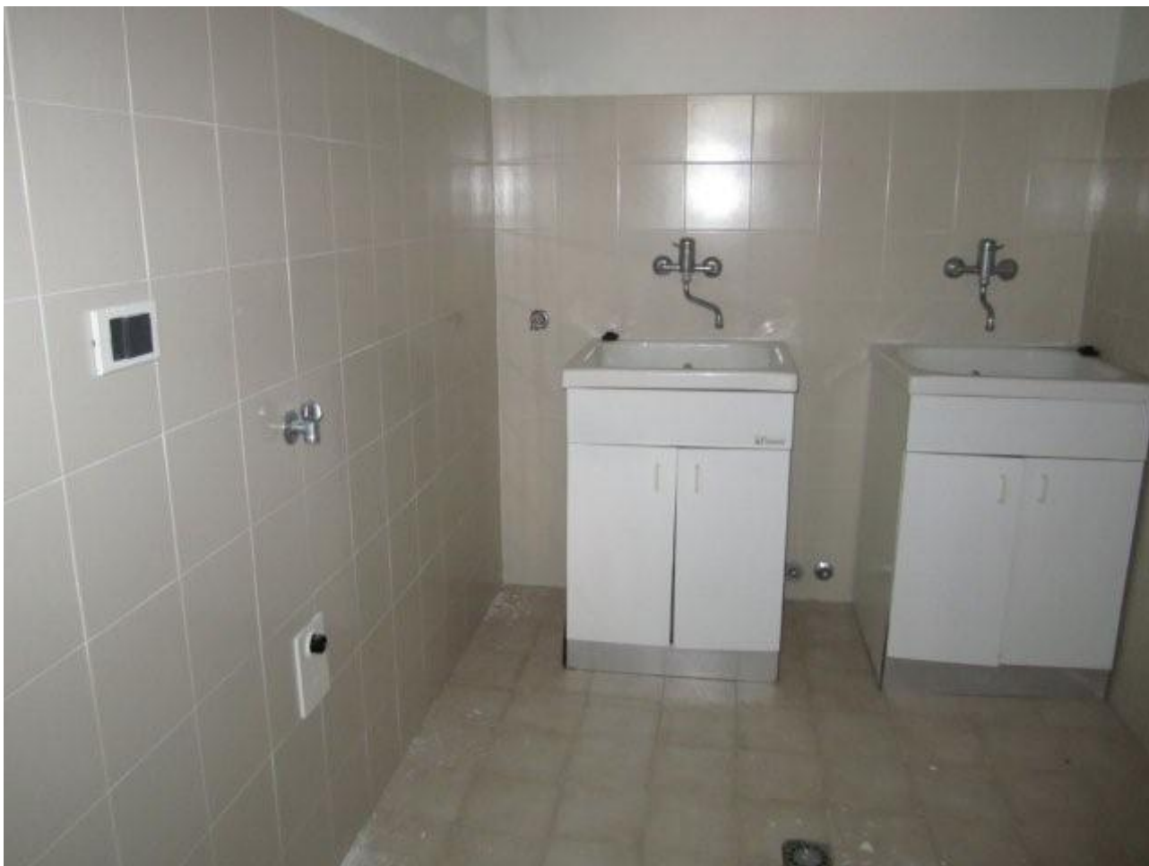
Figura 54: LAVANDERIA, E LE LAVATRICI DOVE SONO FINITE ?.
