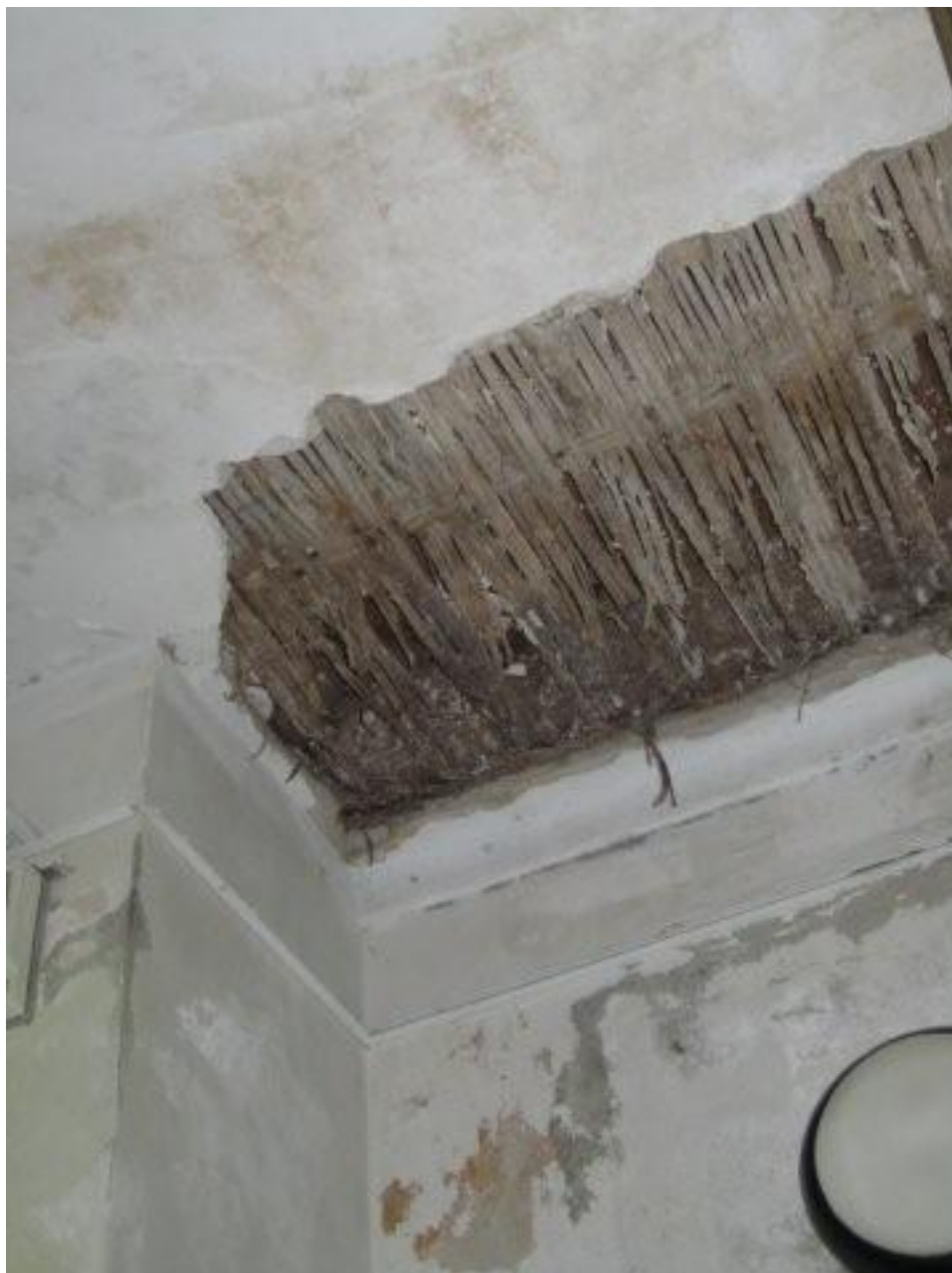
Figura 34: INFILTRAZIONI DAL TETTO CHE ROVINANO L' IMMOBILE.
