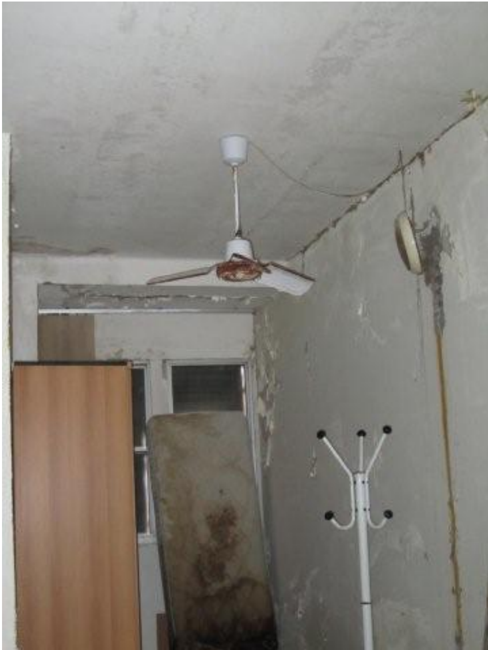
Figura 43: ARREDI NUOVI INFISSI NUOVI ... E UMIDITA' A NON FINIRE.
