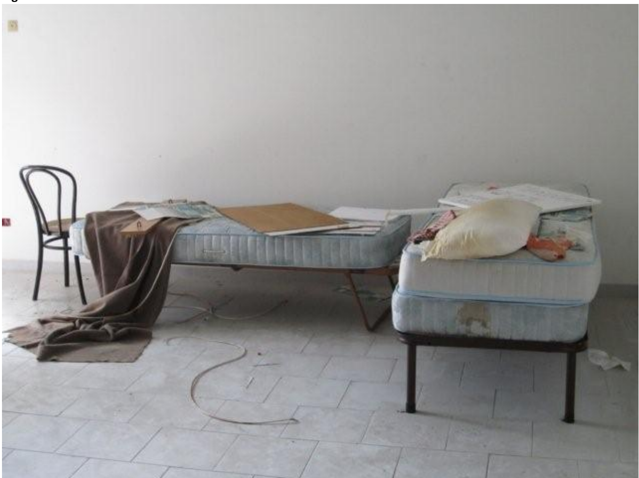
Figura 31: MATERIALE NUOVO IN STATO DI ABBANDONO – PAVIMENTI E PARETI NUOVE.
